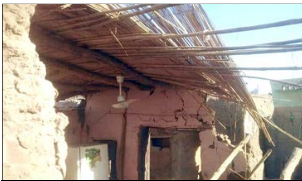
قذيفة (مليشاوية) دمرت هذا المنزل جنوب الخرطوم
